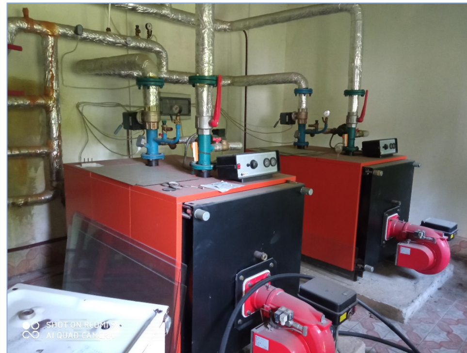
Centrala termică pe bază de gaze naturale și/sau păcură
